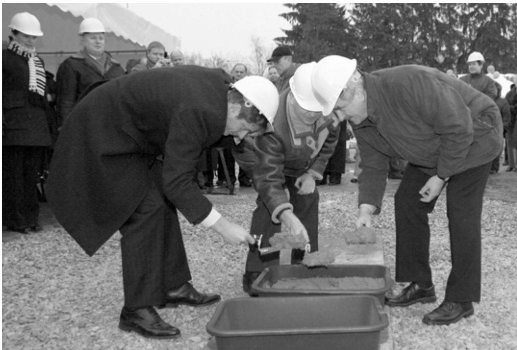
KOOSTÖÖ Ehitusfirma Skanska EMV peadirektor Jaanus Otsa, Riigikogu esimees Toomas Varek ja kliinikumi juhatuse esimees Urmas Siigur katavad uue hoone nurgakivi esimese betoonikihiga.
